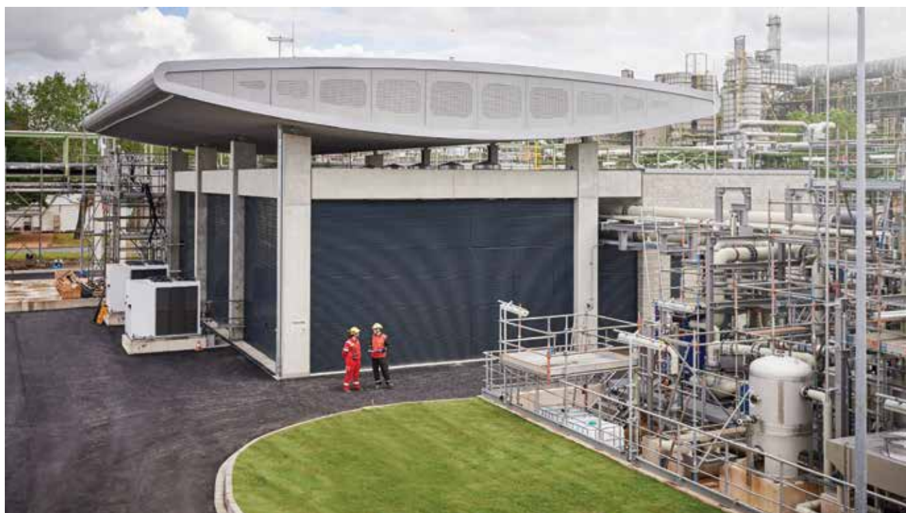
Hình 5. Dự án điện phân hydrogen Refhyne 10 MW của Shell tại Nhà máy Lọc dầu Rhineland, Đức [18].
